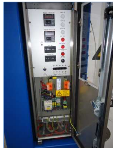
Kontrollbox der Warmwasserheizung
