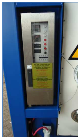
Kontrollbox der Warmwasserheizung
